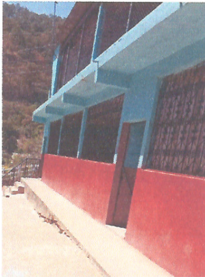
Foto 3: Necesidad de remozamiento del lado frontal del establecimiento en circulación con muro perimetral.
